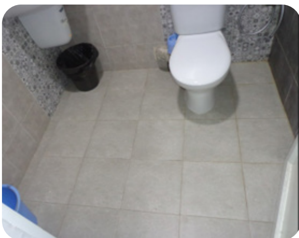
Il n'y a pas de barre d'appui dans la toilette
