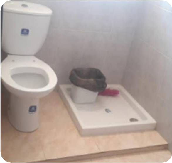
L'accès à la toilette n'est pas adapté aux fauteuils roulants en raison de la présence d'un seuil, d'un espace restreint et de l'absence de barres d'appui
