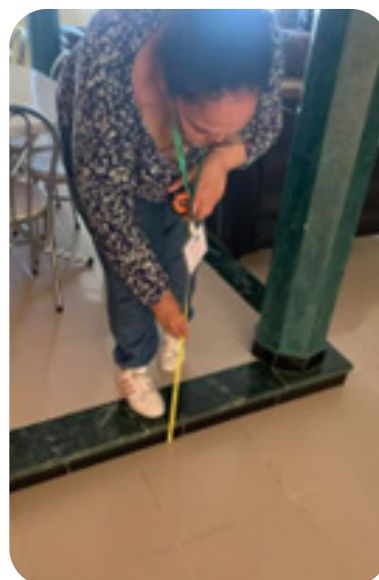
L'un des enquêteurs mesure la largeur du seuil dans le salon
